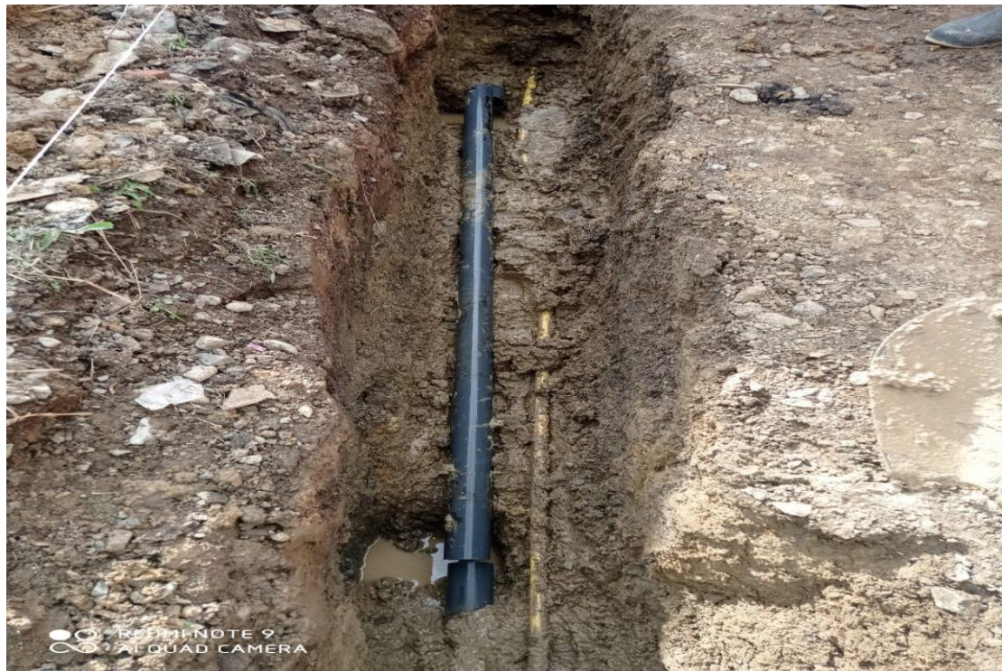
DAÑO TUBO DE 2" SECTOR BARRIO BAJO TEQUENDAMA , ENERO 22 DE 2022
