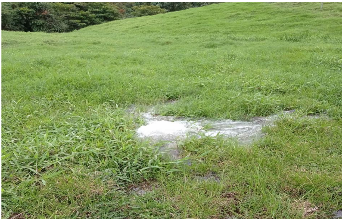
DAÑO TUBERIA RED CONDUCCIÓN 8", EN SECTOR DEL BRILLANTE, NOVIEMBRE 01 DE 2022.
